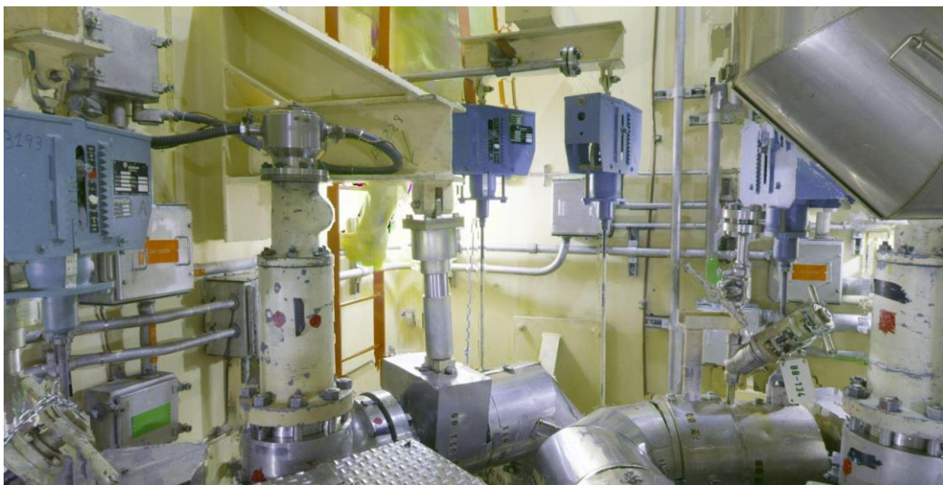
Figura 1. Vista de la sala del presionador de la Central Nuclear de Vandellós II.
